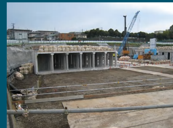
弥生台集合住宅計画に伴う地下遊水池工事 発注者:相鉄不動産(株)
