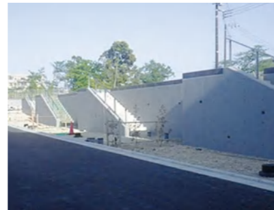
戸塚区北街区・西街区計画宅地造成 発注者:住友不動産(株)・(株)大和地所
